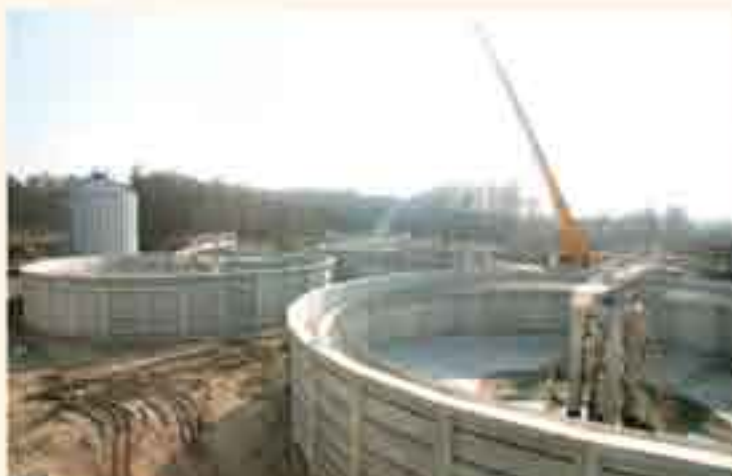
Część biologiczna oczyszczalni - osadniki wtórne
