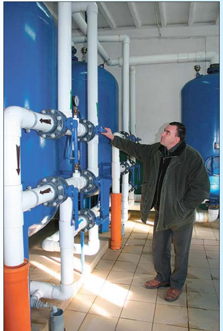
Wydajność nowej hydroforni pozwala zabezpieczyć potrzeby gminy. W rezerwie mamy gotowy odwiert w Smołdzinie – zapewnia Jacek Lahutta.
